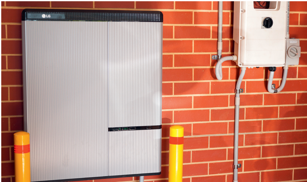
Литијум-јонска кућна батерија марке LG и Solar Edge инвертер соларни панел за кућно складиштење енергије инсталиран у гаражи. Аделејд, Јужна Аустралија.
