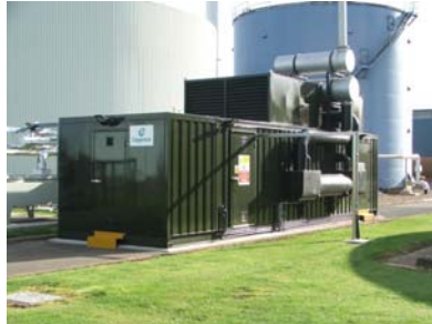
Figure 14 - COGENCO (300kWe) Рус. 14 – COGENCO (300kWe) Слика 14 – COGENCO (300kWe)
