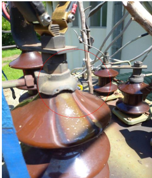
Слика 1: ВН пролазни изолатор у фази „В“ трансформатора Т-1
