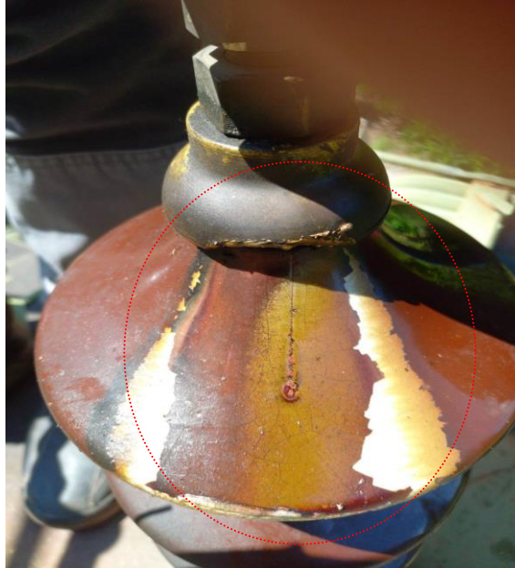
Слика 2: ВН пролазни изолатор у фази „А“ трансформатора Т-1
