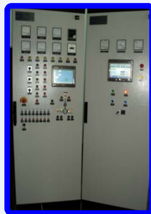
Novi sistem upravljanja ugrađen u prostoriju komandne sale elektrane
